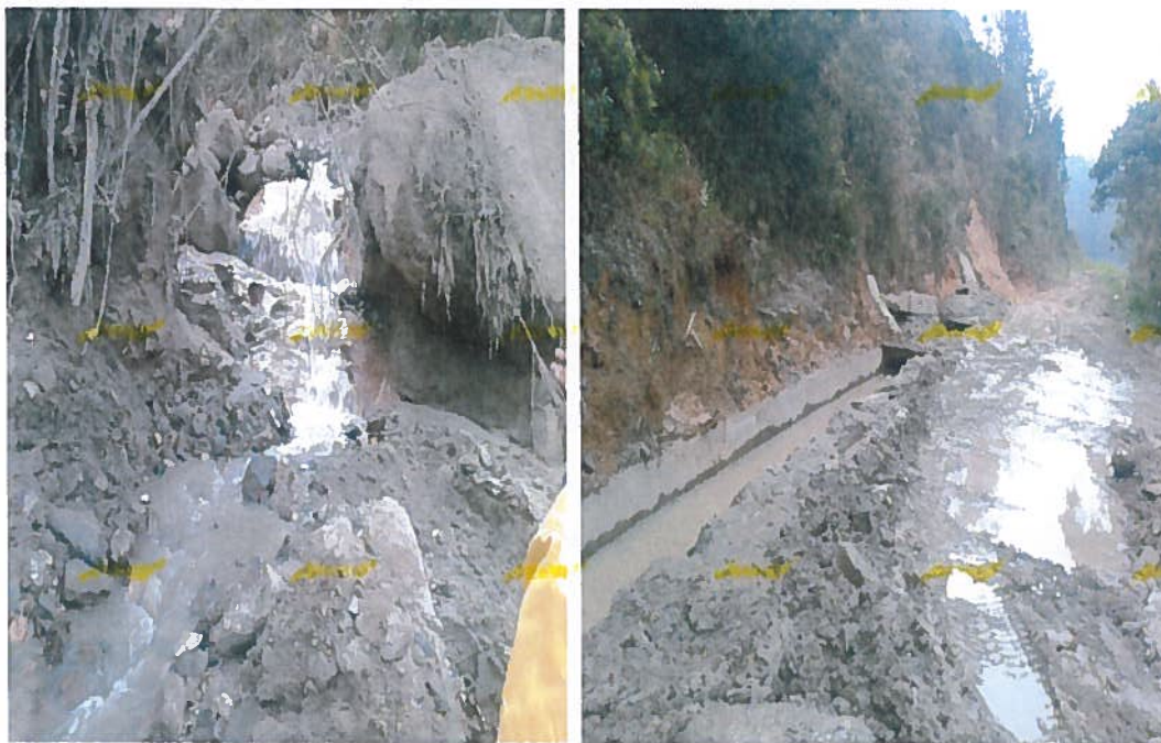
FOTOS 1 Y 2: DESBORDE DE QUEBRADA Y TAPONAMIENTO EN CANAL
