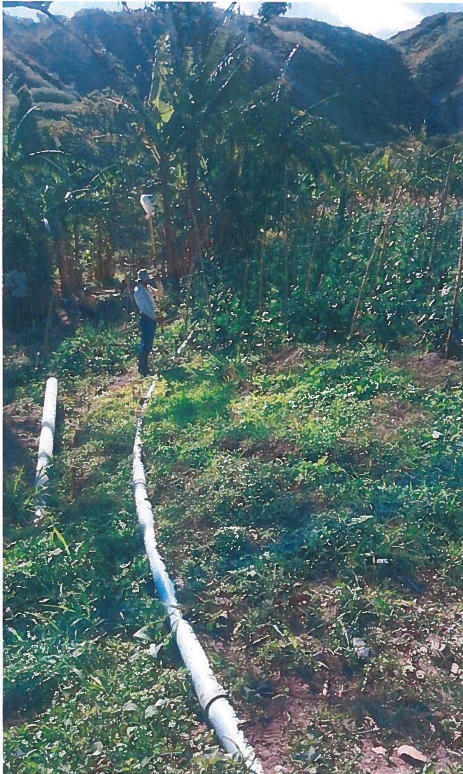
Foto 2. Levantamiento topográfico de las redes secundarias en el sistema de riego La Era
