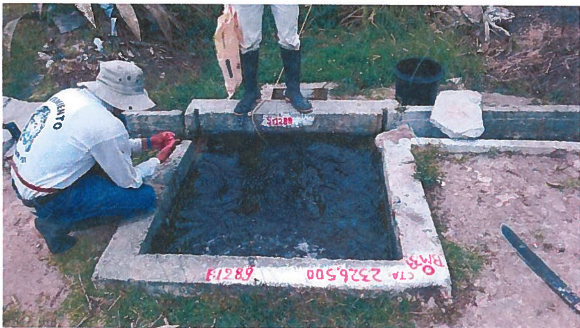
Foto 4. Tanque de distribución con puntos de referencia en caja de distribución de red secundaria en canal de cemento en el sistema El Tablón
