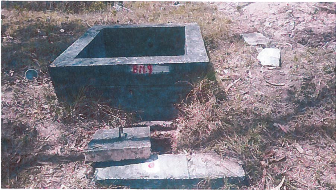
Foto 3. Tanque de distribución de las redes secundarias del sistema de riego Chucchucchir
