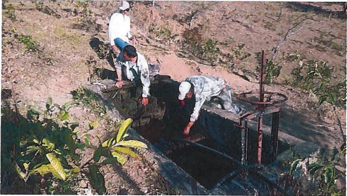
Foto 1. Tanque rompe presiones de los ramales secundarios
