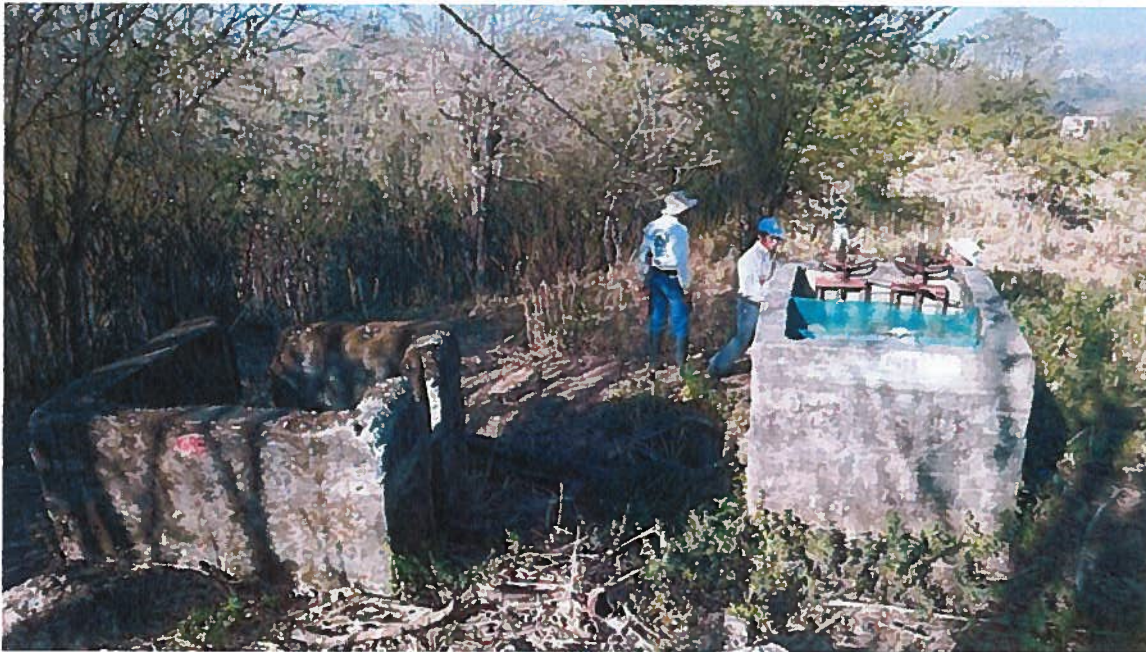
Foto 4. Tanque rompe presiones de las redes secundarias
