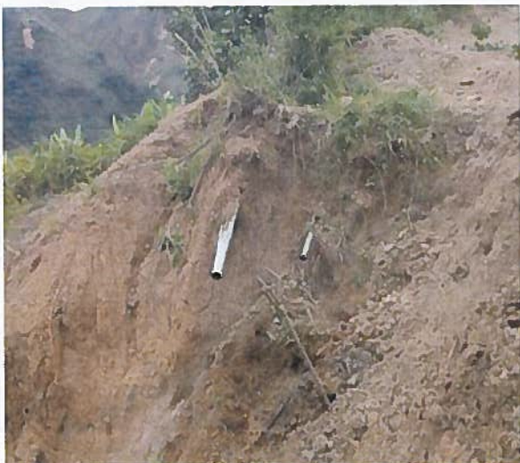
Foto 3. Terciario del ramal La Era afectado por el deslizamiento de suelo
