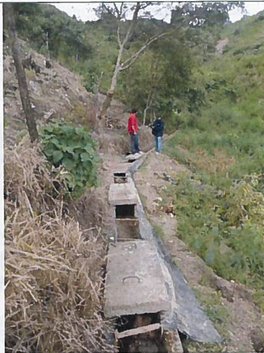
Foto 6. Tramo de canal de ramal San Agustín con problemas de filtración y deslizamiento
