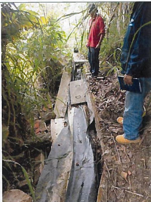
Foto 5. Tramo afectado del canal del ramal San Agustín
