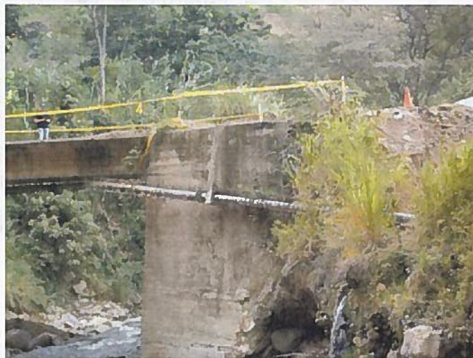
Foto 8. Paso elevado del ramal terciario del canal San Agustín con uniones Gibault en mal estado
