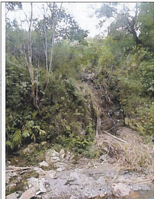
Foto 7. Ramal terciario del canal San Agustín afectado por las lluvias
