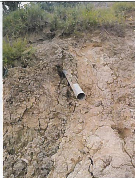
Foto 2. Ramal La Era con tubería de PVC de 110 mm afectado con el deslizamiento de suelo
